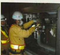
水噴霧装置点検
