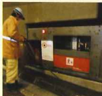
泡消火栓点検
