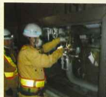
水噴霧装置点検
