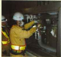
水噴霧装置点検
