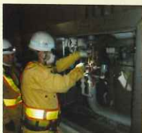
水噴霧装置点検
