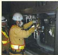
水噴霧装置点検
